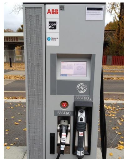
Figur 9: Fylkes eneste hurtiglader er lokalisert til Skagerak Arena, et samarbeid mellom ABB, Odd og Skagerak energi
