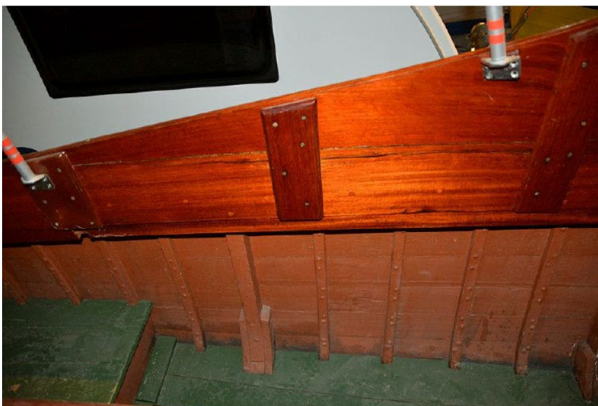
Bilde 24 Innvendig babord side
