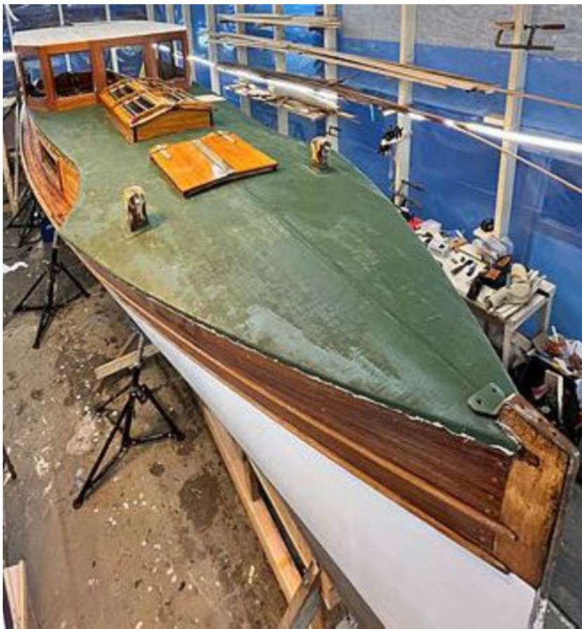
Bilde 48 Seilduken etterstramet og slipt ned for siste støk maling. Luke, og skylight remoter tilbake for optimal tetting til seilduk.
