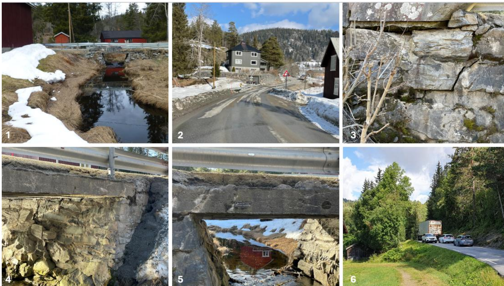
Figur 1: 1. Vrengen bru sett fra øst mot vest (profil). 2. Vrengen bru sett fra sør mot nord. Innsnevring i kjørefelt og krapp sving. 3. Sprekk i brufundament. 4. Sprekk i brufundament. 5. Dagens brudekke. 6. Smal passering for møtende trafikk sør for Vrengen bru. Alle bilder tatt av VTFK/TFK.
